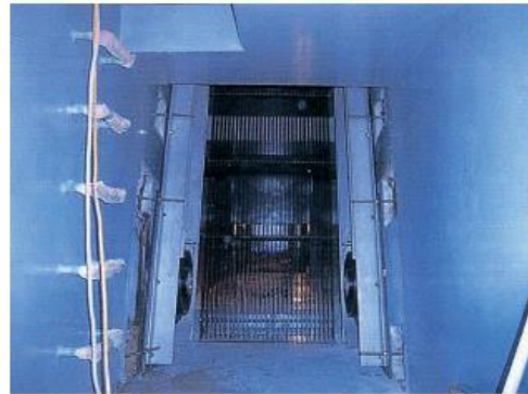
ポンプ場沈砂池(改築工事後)
