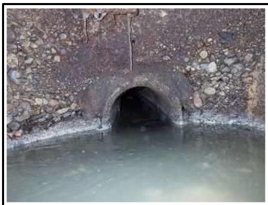
耐震性不足のマンホール内部
