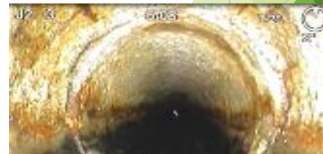
老朽化した下水道管
