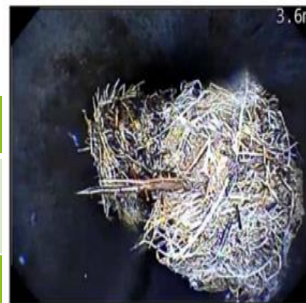
老朽化した既設管
