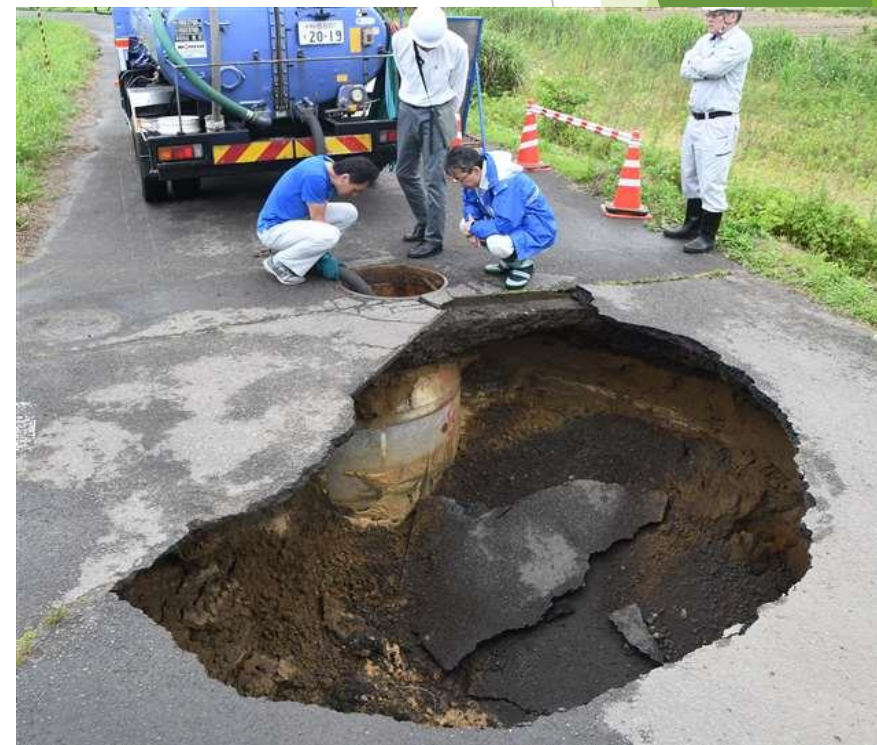
(参考) 道路陥没
