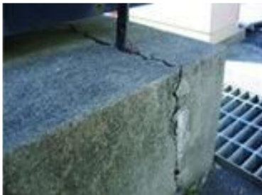
看板基礎部分のひび割れ
