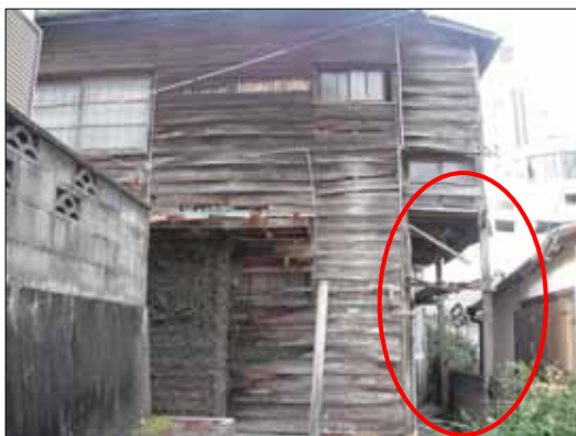
柱の数箇所に破損がある例 (50点)
