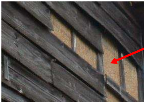
事例) 仕上材（木板）の剥離（部分的）により、外壁の下地露出（評点15）
