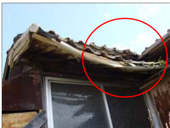
軒の裏板、たる木等が腐朽し、 軒が垂れ下がっている例（25点）
