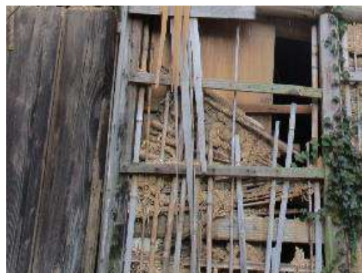
事例）壁体を貫通する穴を生じている（評点25）
