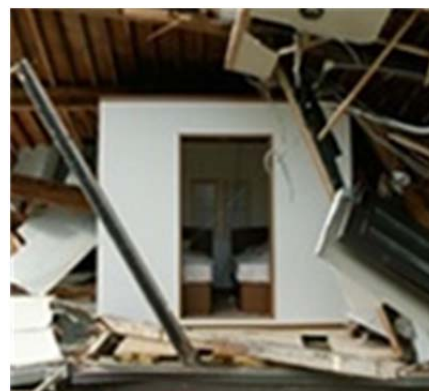
（耐震シェルターの例）
